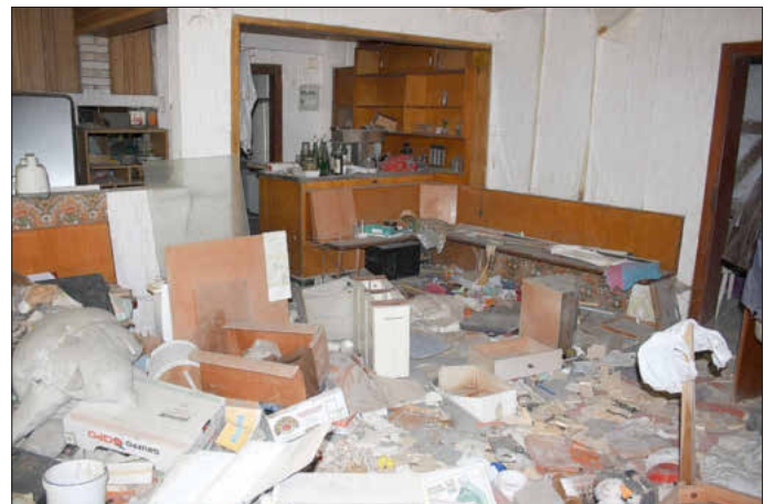
Ein Blick in das ehemalige Gastzimmer – auch alle anderen Räume sind vermüllt.
