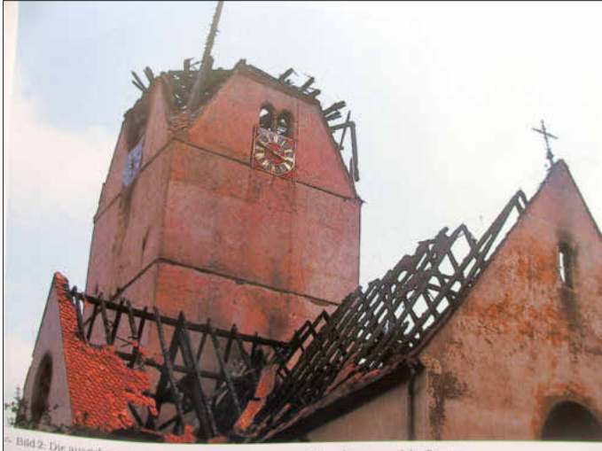
Auch die bunte Turmeindeckung war komplett zerstört.
