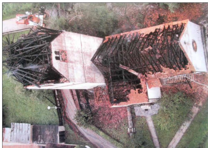
Die Kirche nach dem Brand – Dachstuhl von Kirchenschiff und Turm wurden zerstört.
