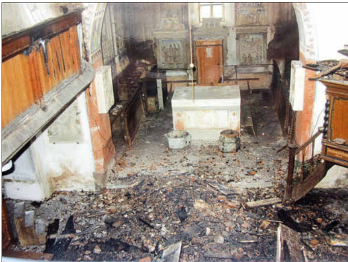
Ein Blick in das Innere gibt einen Eindruck über die Beschädigungen.
